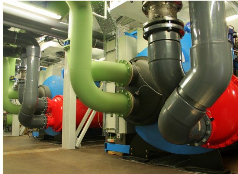
Auch für Anlagen zur Kälteerzeugung will der VfW an neuen Finanzierungskonzepten mitarbeiten (Foto: Cofely Refrigeration)
