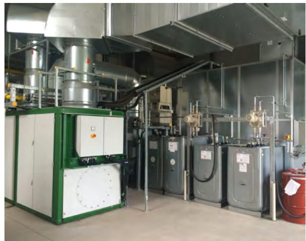
KWK-Anlage: Dezentrale Erzeugungskapazitäten gelten als Merkmal der Energiewende
