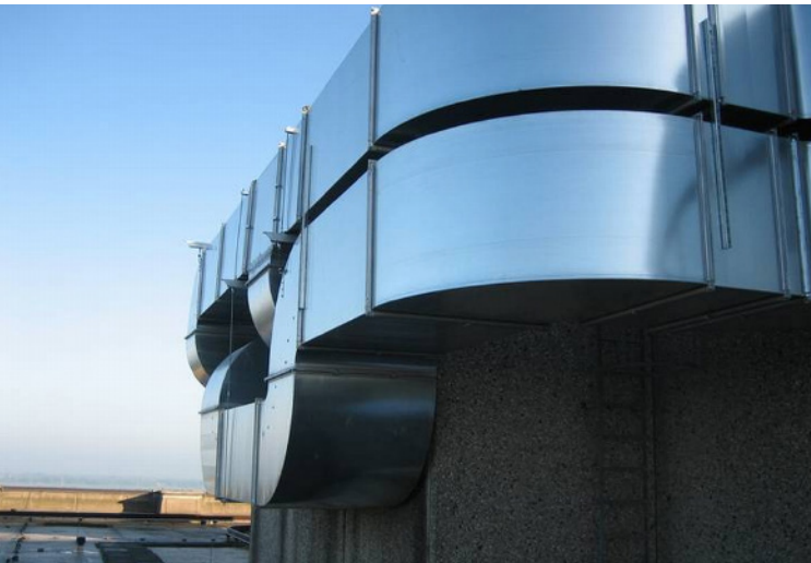
Dachzentrale des Klinikums Bremerhaven. Der Energieverbrauch des Krankenhauses wurde per Einsparcontracting gesenkt. (Foto: Siemens)
